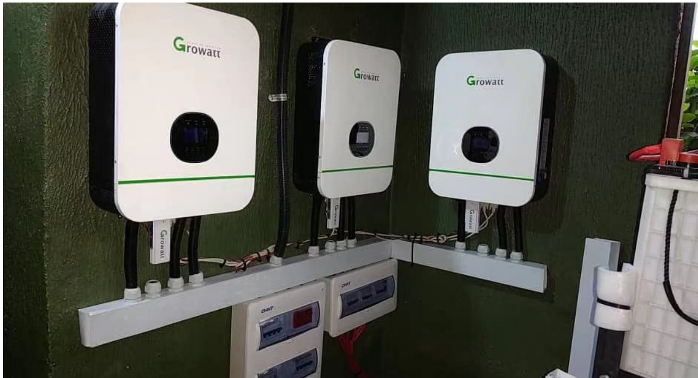
► 15KW Three phase system ► Nigeria ► SPF 5000 TL HVM-P
