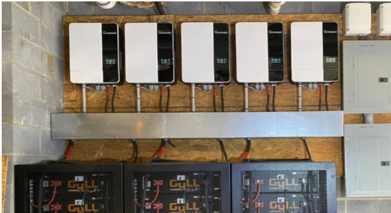
► 25kW single phase system ► Mexico ► SPF 5000ES
